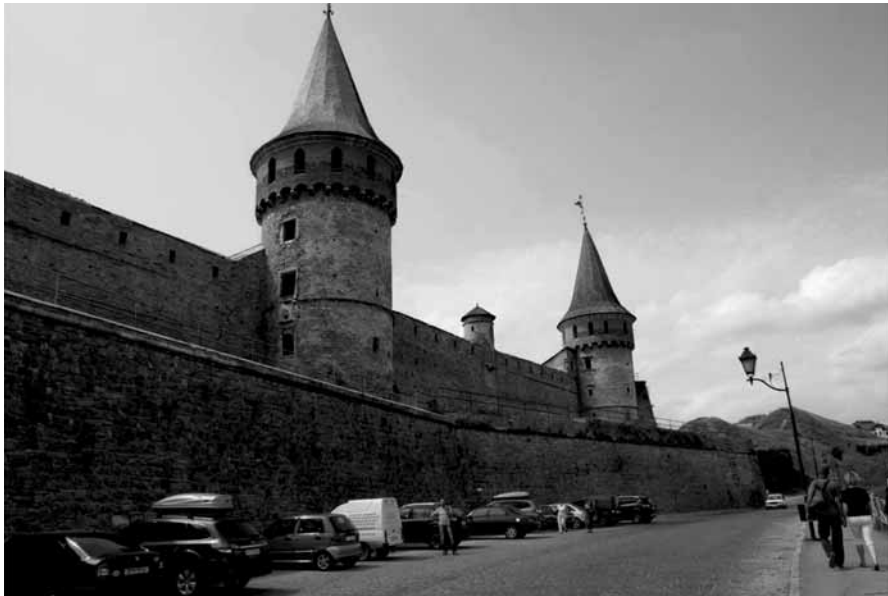
Odrestaurowywany kryty ganek łączący Basztę Różanka z Basztą Lanckorońską, którego odcinek dochodzący do Baszty Komendanckiej udostępniony został zwiedzającym. Stan z 2013 r. Fot. A. Smoliński
