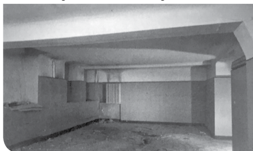
Piwnica apteki przy Nowym Świecie. Żelbetowe stropy wytrzymały bombardowanie mimo iż budynek runął.
